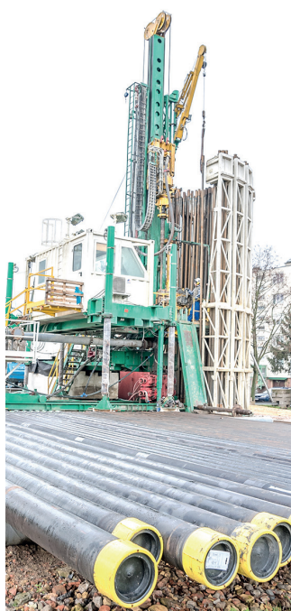
A Gáz utcai geotermikus fűrés már csak emlék. Az eredmény: korszerű környezetbarát fűtés a környező lakótelepen. Archiv fotó: Iványi Aurél
